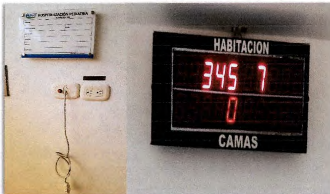
Imagen N°4: Sistema de llamado de Enfermería
